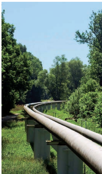
Το σύστημα αγωγών Druzhba (φιλία) στα σύνορα Τσεχίας-Σλοβακίας. Πρόκειται για το μεγαλύτερο δίκτυο αγωγών αργού πετρελαίου στον κόσμο, που συνδέει τη Ρωσία με τη Γερμανία, και είναι μία από τις προτεραιότητες των διευρωπαϊκών δικτύων ενέργειας (ΔΕΔ-Ε).
